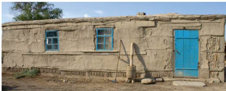
Қыстық тұрғын үй – қақыра. Сырдария ауданы, С.Сейфуллин ауылы. 1950 жж. Картаева Т.Е. Сыр өңірі қазақтары: тарихи-этнографиялық зерттеу (XIX ғасырдың екінші жартысы – XX ғасырдың басы). Екі томдық. 2-том. Алматы: Қазақ университеті, 2014. 307 б.
